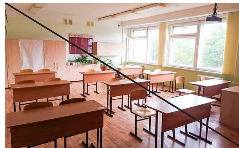
Плохо Линолеум под дерево
